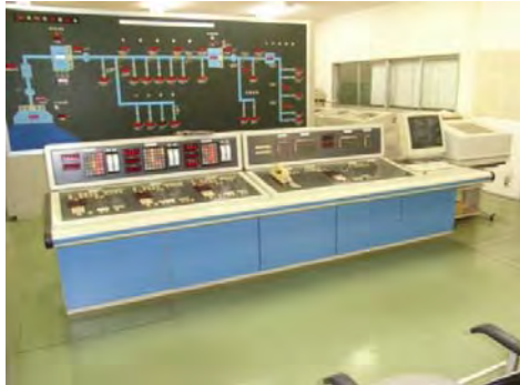
センター設備
