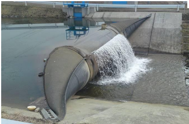
【ゴム堰の全体写真】
