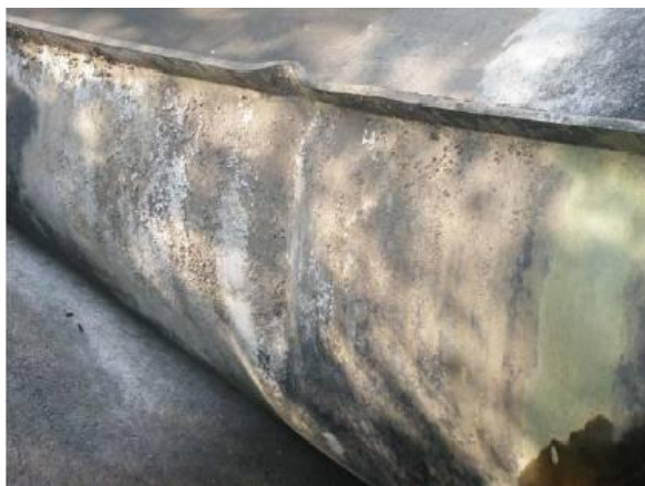
写真 2.1.2 袋体外面の劣化状況例
