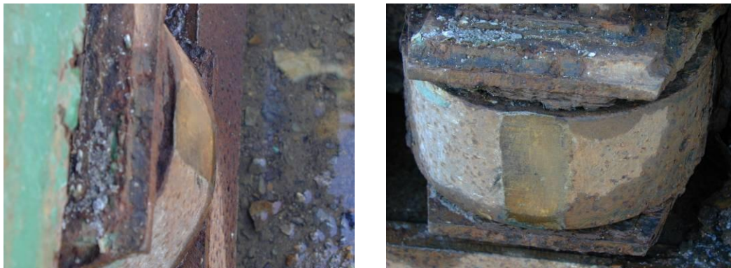
写真 2.1.1 ゲートのサイドローラ部の摩耗
