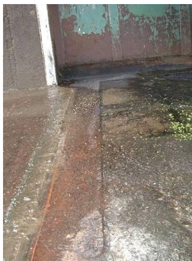
写真 2.1.6 底部戸当りの腐食
