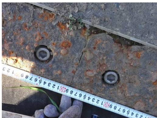
写真 2.1.7 ゴム堰取付金具の腐食
