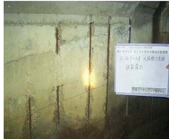
鉄筋被りが不足している箇所のひび割れ・剥離
