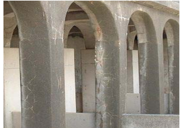
ASR と塩害の複合劣化で、鉄筋に沿ったひび割れや亀甲状のひび割れが混在
