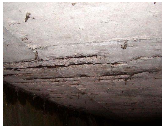
頂版の鉄筋に沿ったひび割れ
