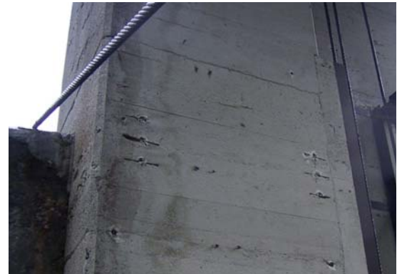
門柱；鉄筋に沿ったひび割れ
