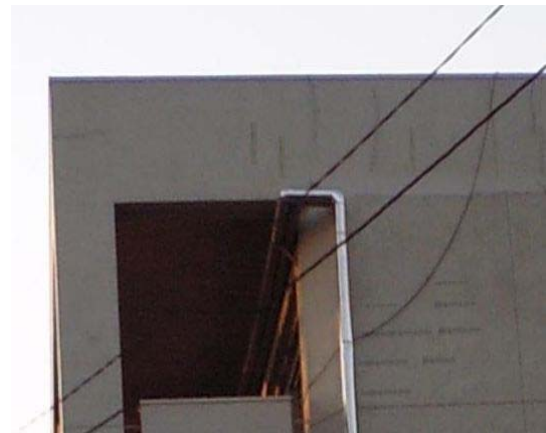
鉄筋に沿ったひび割れ
