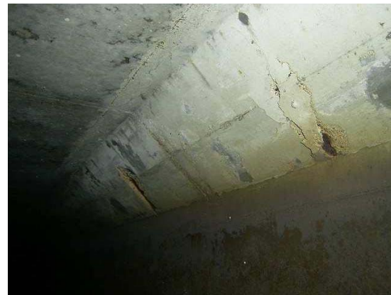
ハンチ部のひび割れ・剥離
