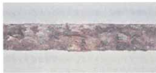
腐食度区分：D 又は IV
