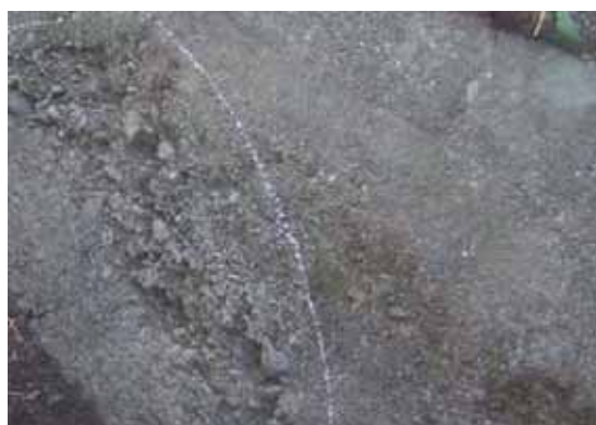
図 3. 2-7 開水路側壁の豆板
