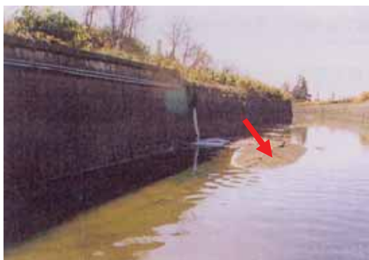
図 2.2-2 開水路底版 (揚圧力による損傷)
