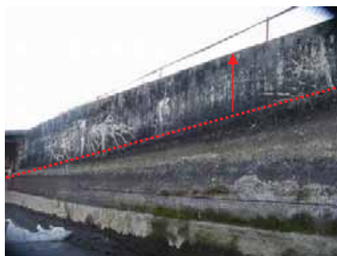
図 3.3-7 コンクリート開水路側壁喫水線上部に生じた凍害
