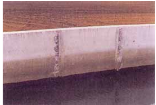
図 2.2-5 開水路側壁 (膨張による継目周辺の破損)
