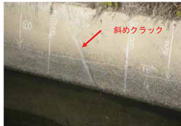
図 3. 4-6 開水路に生じた外力によるひび割れ
