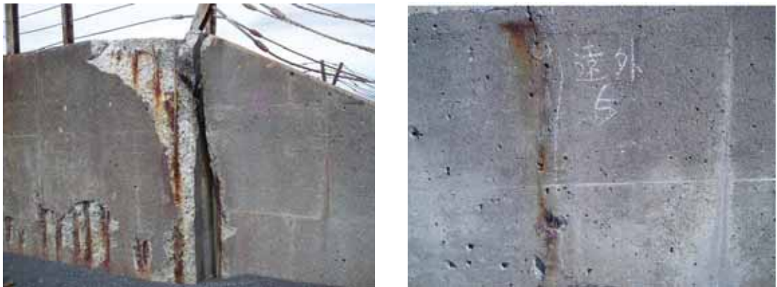
図 3.3-37 塩害による変状
