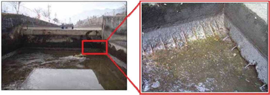
図 3.3-3 落差工に生じた物理的作用による摩耗
