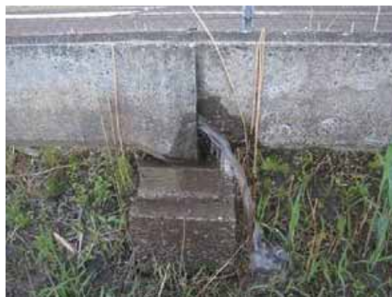
図 3. 4-2 不同沈下による目地からの漏水
