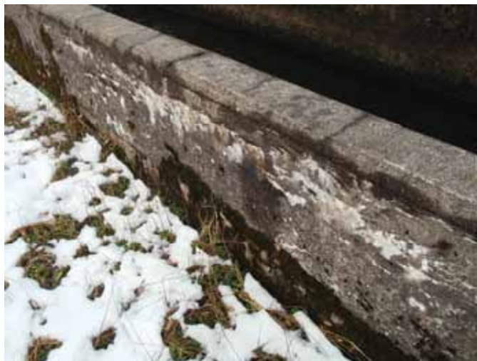
【側壁のひび割れ等の変状発生状況】
