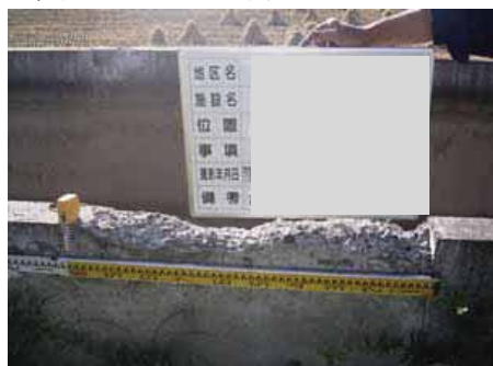
図 3.3-8 側壁天端に生じたスケーリング
