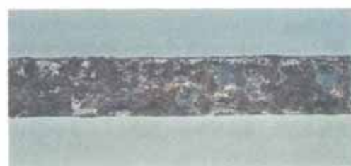
腐食度区分：C又はⅢ
