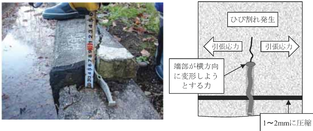
図 3.4-10 止水板から長手方向に生じたひび割れ
