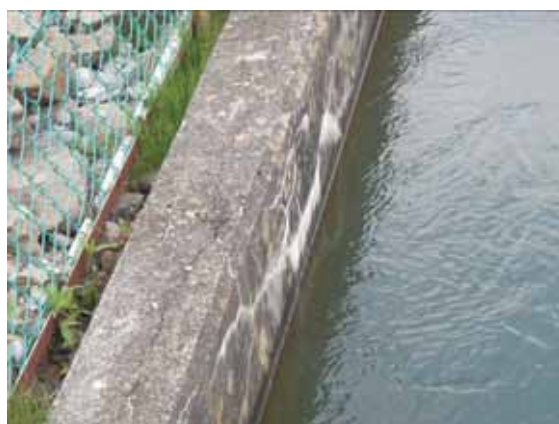
図 3.3-14 アルカリシリカ反応による亀甲状のひび割れとゲルのしみ出し
