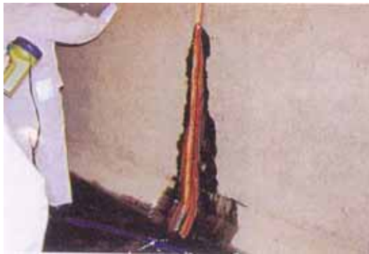
図 2.2-4 開水路側壁 (継目からの漏水)
