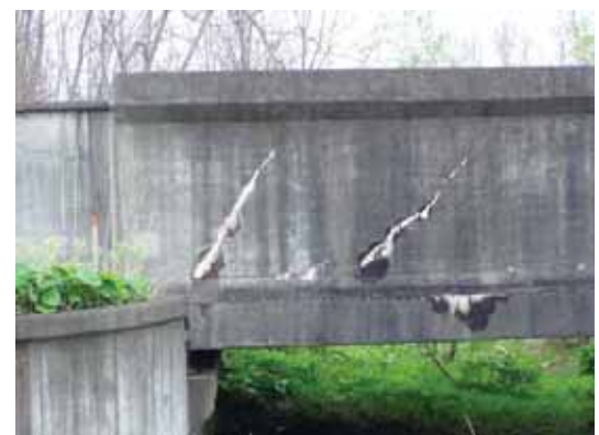
図 2.2-7 水路橋 (せん断力によるひび割れ)
