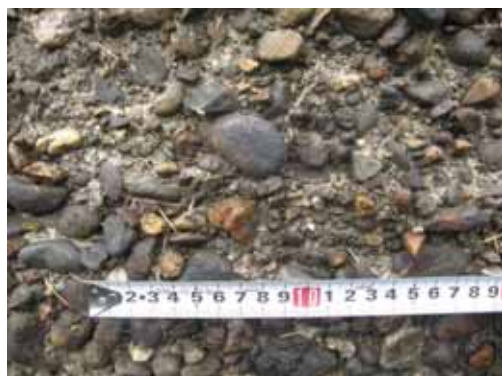
図 2.2-8 開水路側壁 (摩耗による骨材露出)
