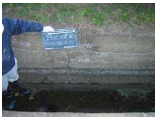
図 3. 2-8 開水路側壁のコールドジョイント
