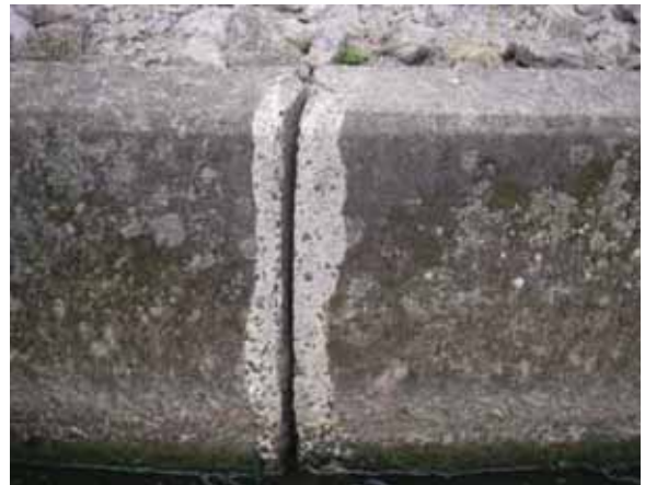
図 3.4-9 目地材なし（板材系目地の腐食）
