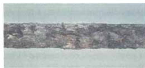
腐食度区分：D又はⅣ
