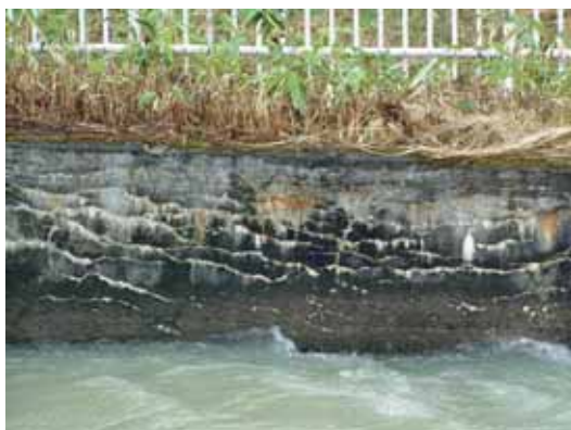
図 2.2-6 開水路側壁 (凍害によるひび割れ)
