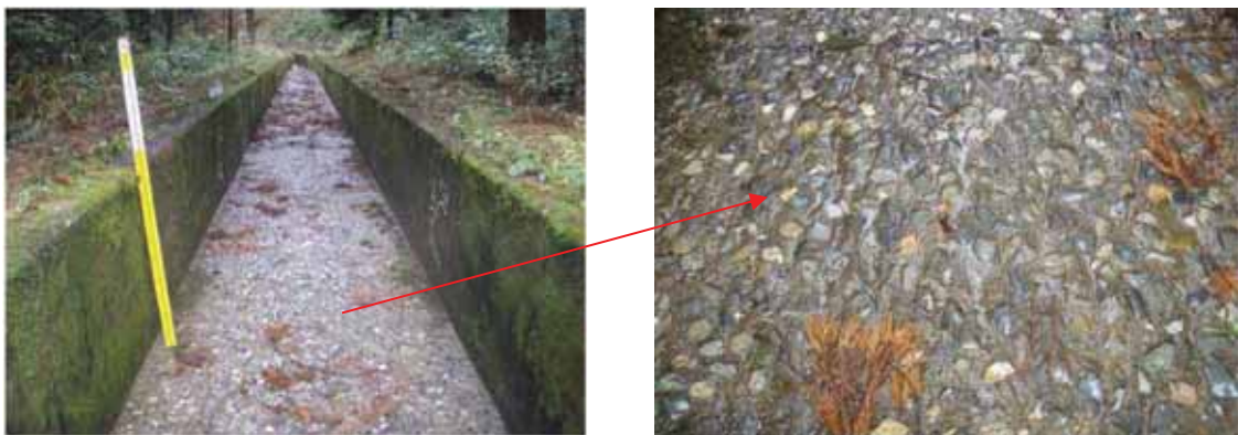
図 3.3-4 急流工に生じた物理的作用による摩耗
