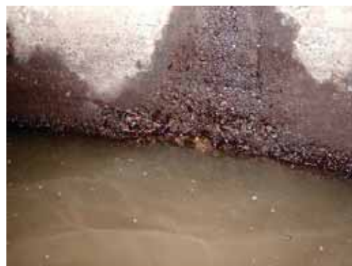
図 2.2-9 開水路側壁 (豆板)
