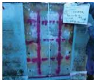
裏込め材の状況天端20cm程度 度中性化
