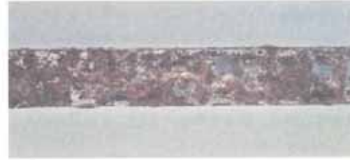
腐食度区分：C 又は III
