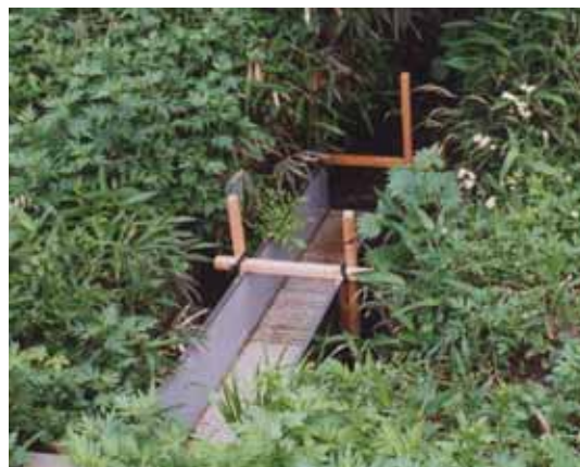
U字溝排水路と谷川を連結する簡易タイプの魚道
