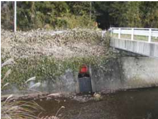
河川と排水路が分断されているため、生物の移動は困難になります。
