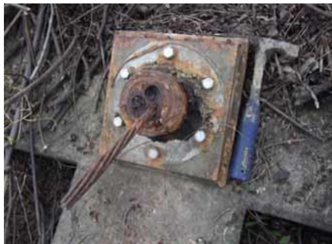
図 2-4 テンドンの腐食事例
