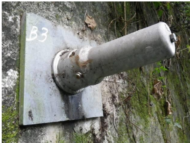
図 2-14 頭部キャップ周辺の防錆油漏れによる汚れの事例
