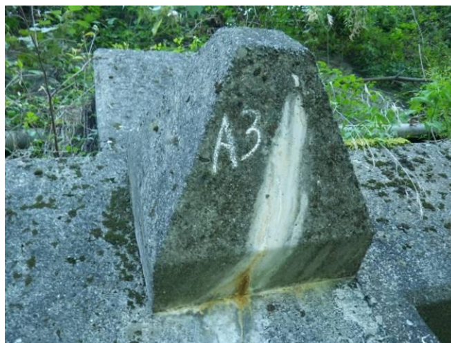
図 2-6 頭部コンクリート背面からの漏水・錆汁の事例
