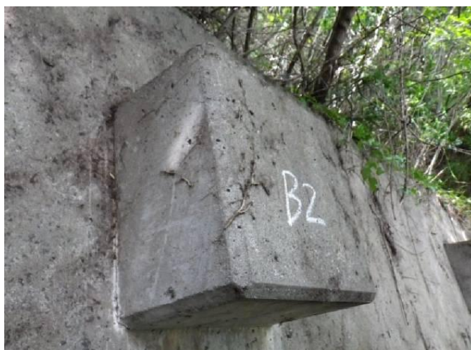
図 2-10 頭部コンクリート背面に隙間の事例
