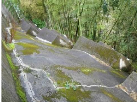
アンカー周辺の吹付工の変状
