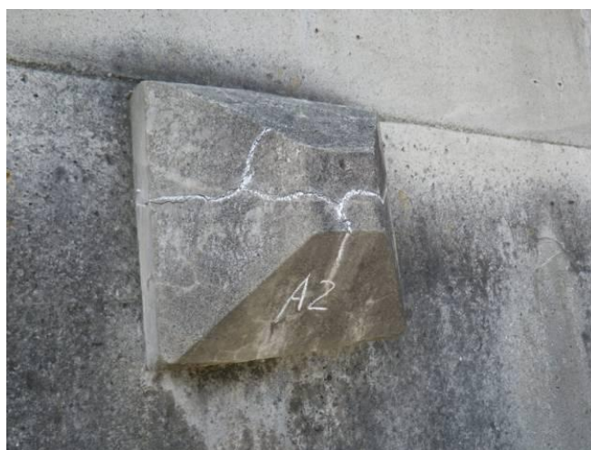
図 2-8 0.5mm 幅を超える程度のひび割れの事例
