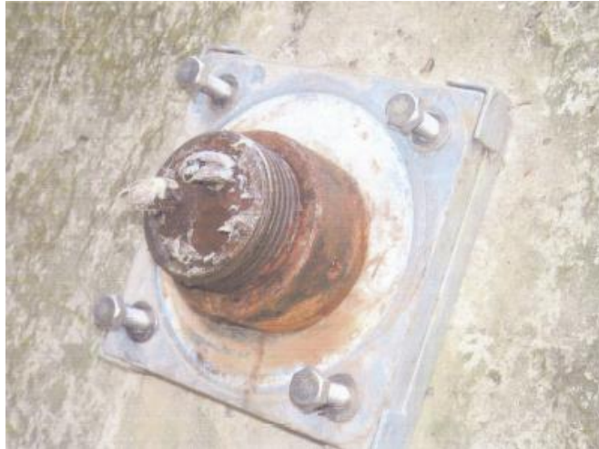
図 2-23 定着具の腐食の事例
