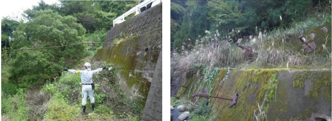
図 2-1 テンドンの飛び出し事例（腐食による破断）
