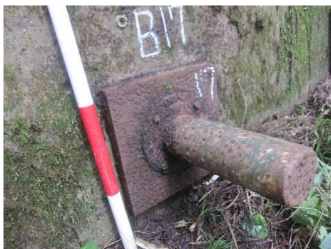
図 2-12 頭部キャップの材質劣化・肉厚減少や浮きを伴う腐食の事例
