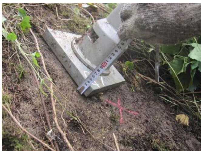
図 2-16 頭部・プレートの浮きの事例
