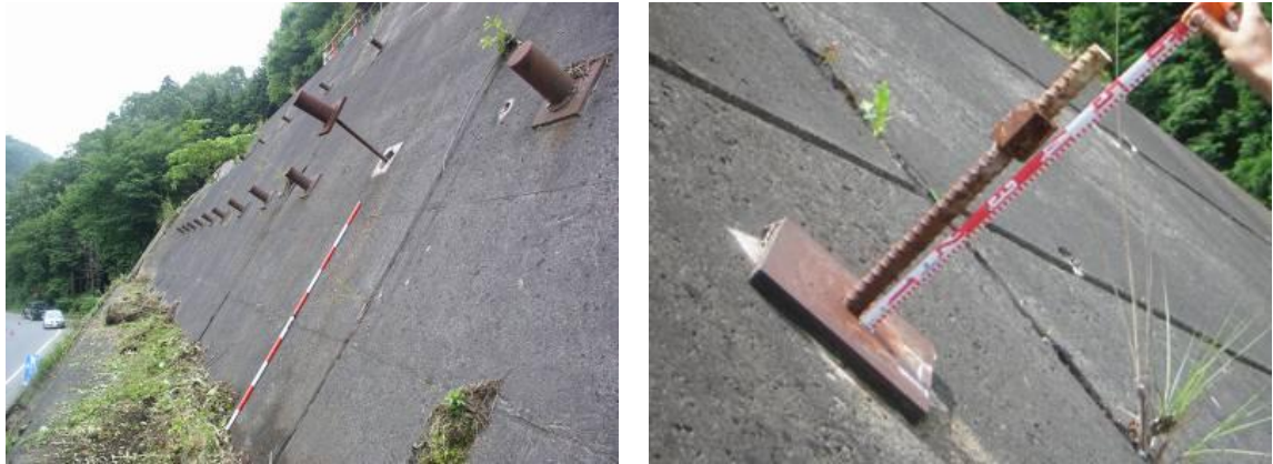
図 2-3 テンドンの飛び出し事例（定着地盤の風化による摩擦抵抗の低下）
