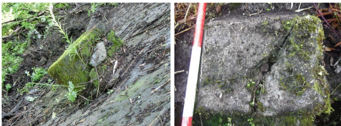
図 2-7 破壊・部分的な欠損の事例
