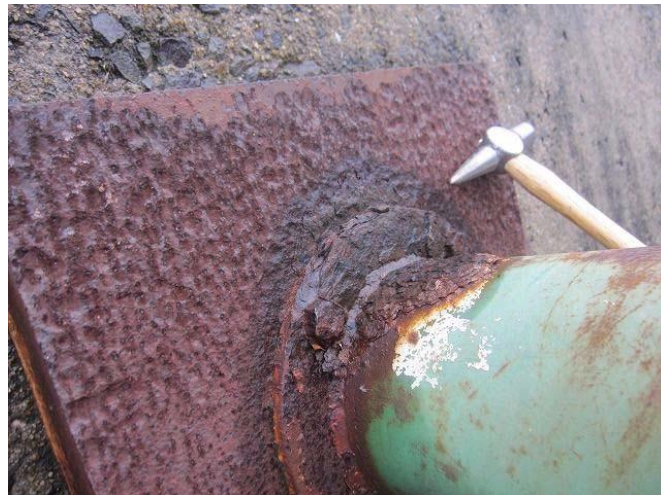
図 2-18 プレートの肉厚減少や浮きを伴う腐食の事例
