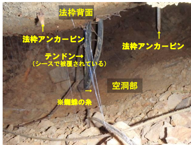
図 2-2 吹付法枠工背面の空洞部
