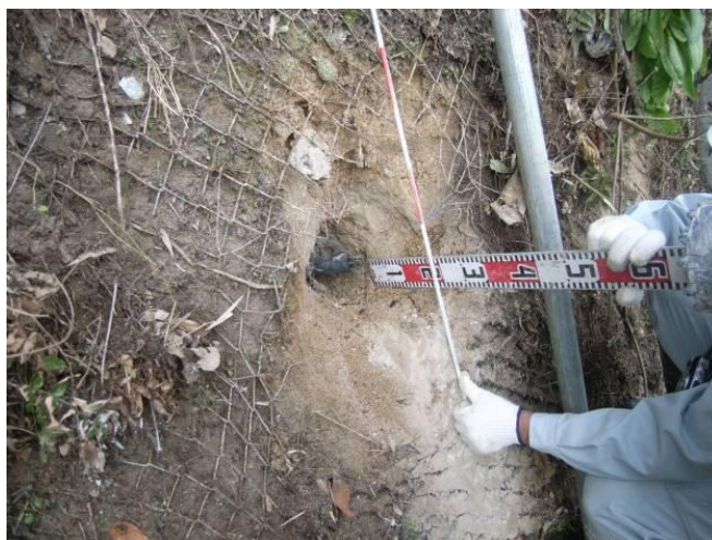
図 2-8 受圧構造物落下箇所状況
