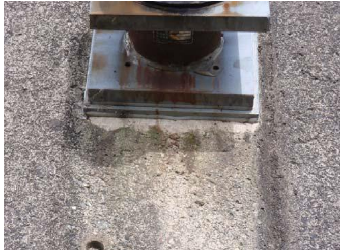
図 2-17 プレート背面からの漏水の事例
