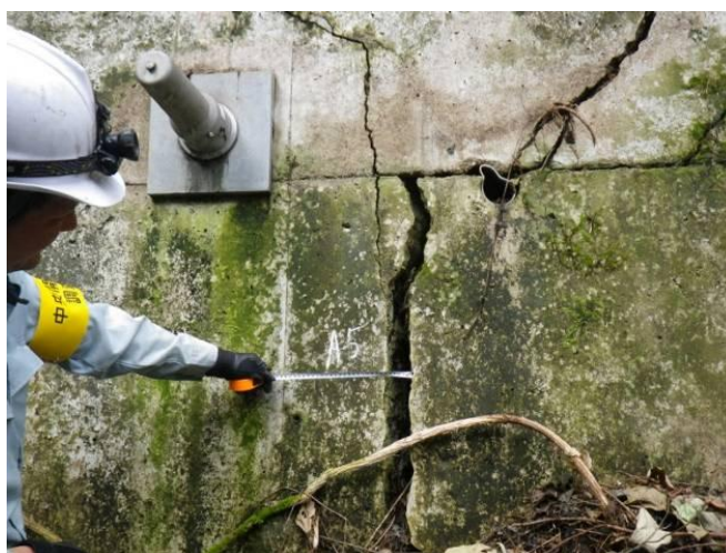
図 2-19 受圧構造物に生じたひび割れ、段差等を伴うひび割れの事例
