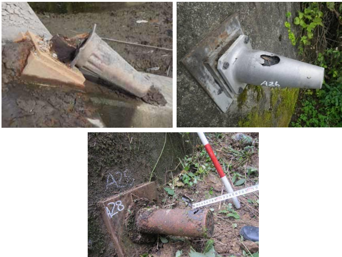
図 2-11 頭部キャップの損傷の事例
