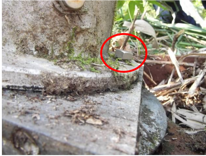
図 2-13 固定ボルトの緩みの事例
