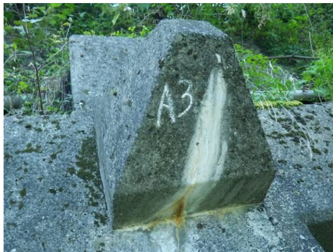
図 2-6 頭部コンクリート背面からの漏水・錆汁の事例
