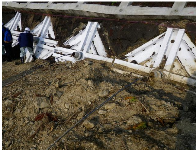
図 2-2 テンドンの飛び出し事例（斜面崩壊による破断）
