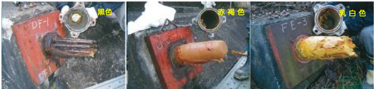
図 2-22 防錆油の劣化の事例
