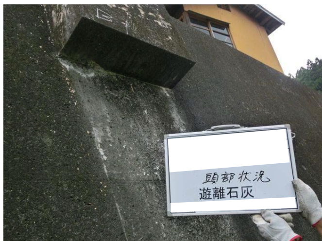
図 2-9 頭部コンクリートからの遊離石灰の事例
