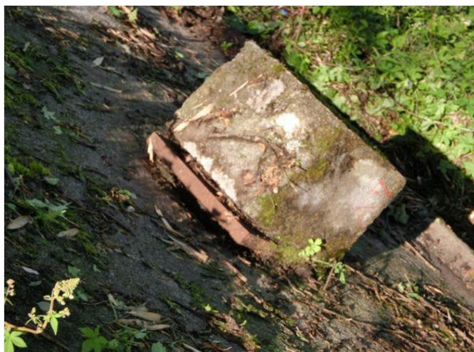
図 2-5 頭部コンクリートの浮き事例
