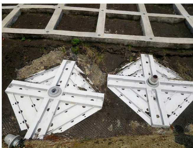
図 2-20 受圧構造物の大きな変状の事例
