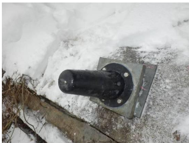
図 2-1 対象箇所に設置されたアンカー
