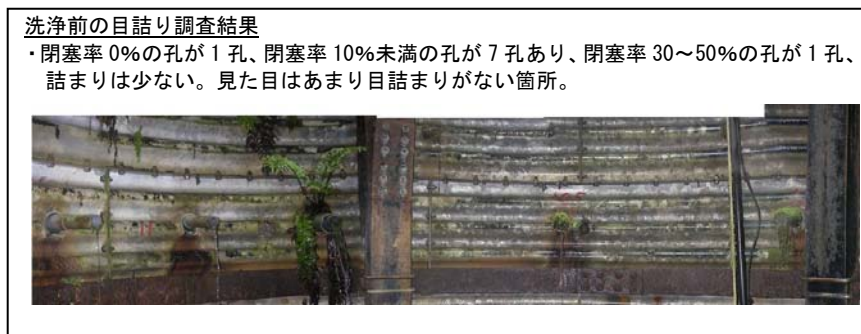
図 2.3.2 (3) 洗浄前の集水ボーリングの目詰まり状況
