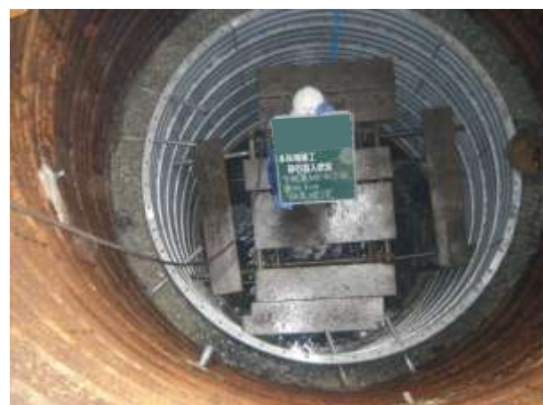
パイプ類接続状況
