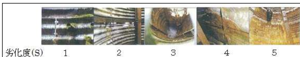
図1 集水井ライナープレートでの目視による劣化度評価事例
