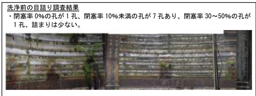
図 2.1.2 (3) 洗浄前の集水ボーリングの目詰まり状況
