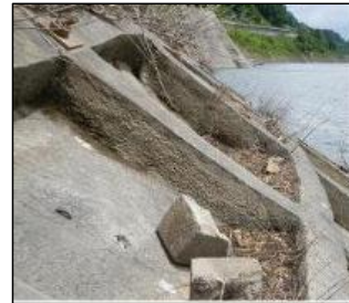
図1.4: 頭部コンクリートが落ちている
