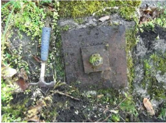
「なくなっている（頭部コンクリート）」
