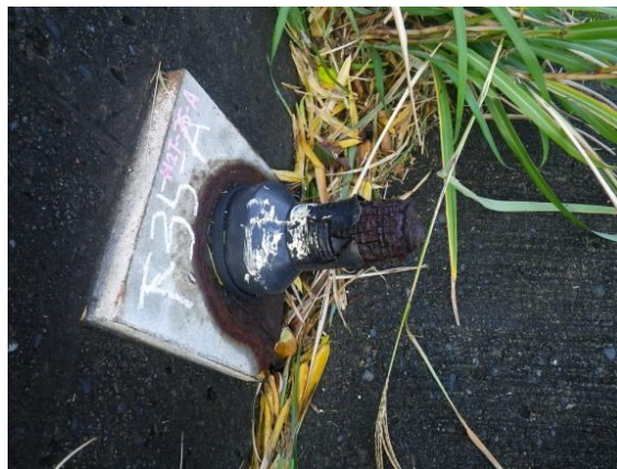
図 3-17 海岸近くで塩害の影響を受けたテンドンの腐食事例
