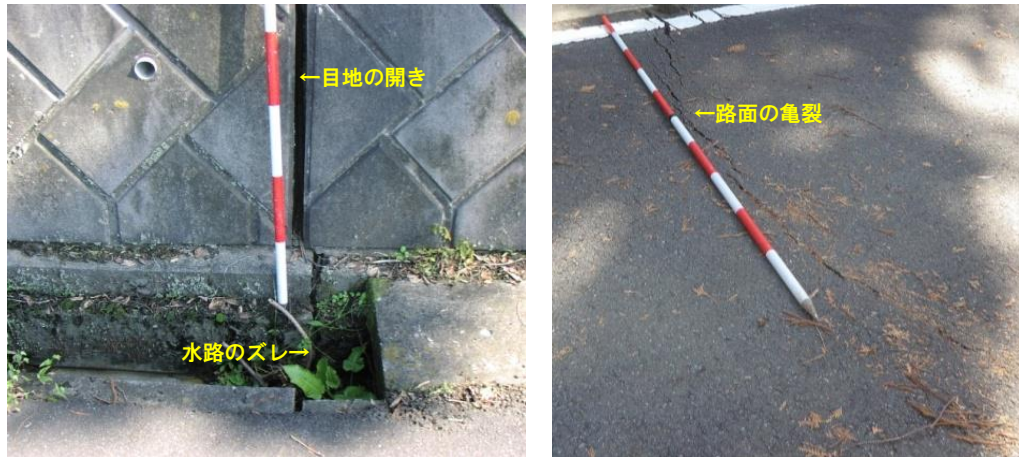
図 3-15 道路やコンクリート構造物に見られる変状の例
