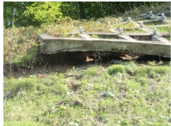
「地表の沈下」 (滑落崖の形成)
