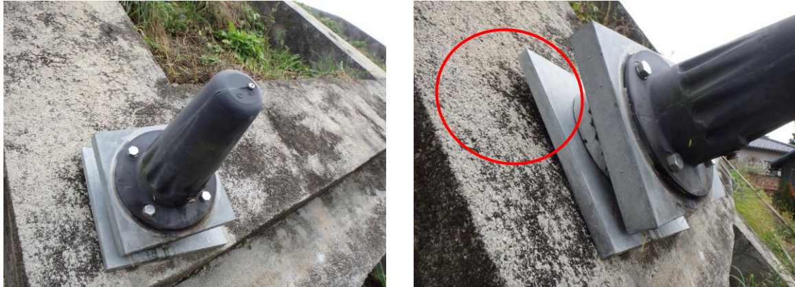
図 3-12 側部からの点検で異常が確認しやすくなる例 （右の写真のように側部からみるとプレートの浮きが容易に判断できる）
