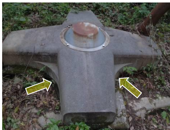
「浮き上がり」 (背面土砂流亡)
