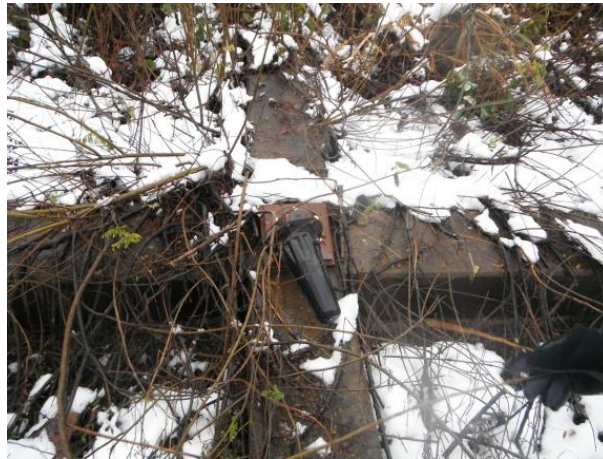
図 3-18 積雪荷重の影響を受けた頭部キャップの事例
