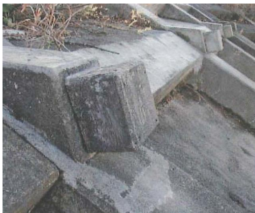
①頭部コンクリート この状態で容易に頭部露出をすることは不可能。
