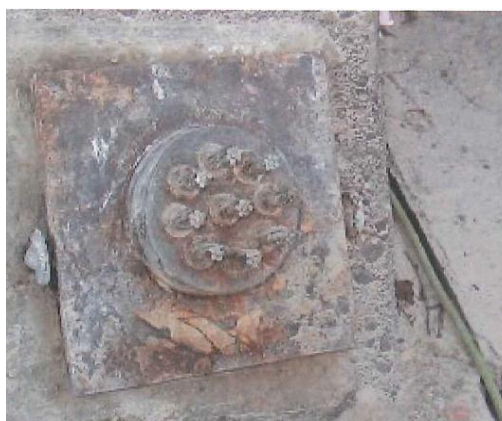
③アンカー頭部露出 写真例はくさびタイプの定着具を使用している事例。
