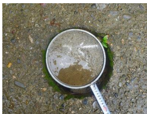
杭頭周辺の変状事例 (杭の隙間：隙間最大 40mm)
