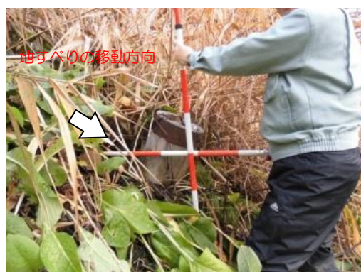
杭頭周辺の変状事例 (谷側へ約 20 度傾き)
