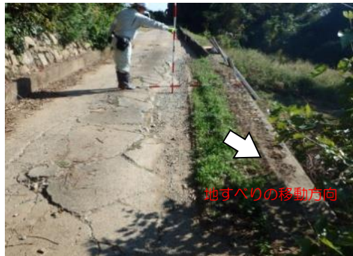
杭頭周辺の変状事例 (杭の谷側路面沈下)
