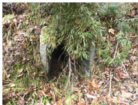
④施設横の空洞がある (※施設とは関係のない、室のようなものであった)
