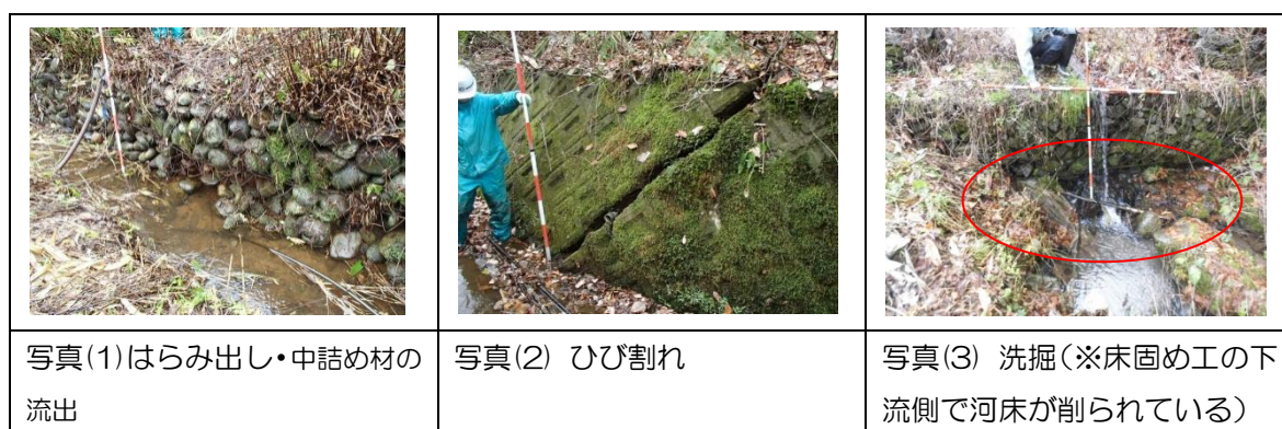
図 4.2.2 異常事例(溪流護岸工)
