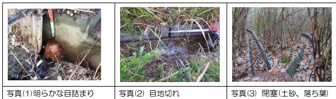
図 4.2.1 異常事例(暗きょ工・明暗きょ工)
