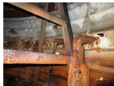
集水井の目詰まり
