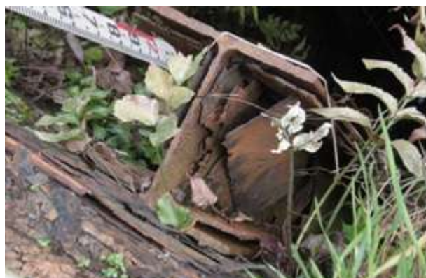
パーティカルスティフナーの腐食 (剥離、減厚顕著)
