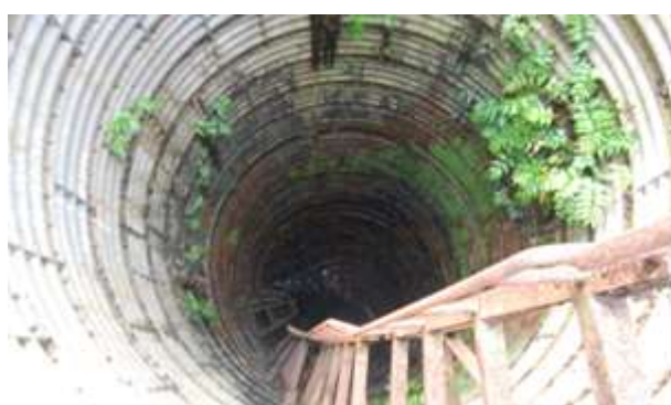
集水井内部の湧水状況 (コケが生えている深度に湧水、錆発生)
