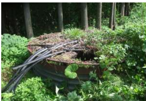
天蓋の腐食 (部分的に欠落)
