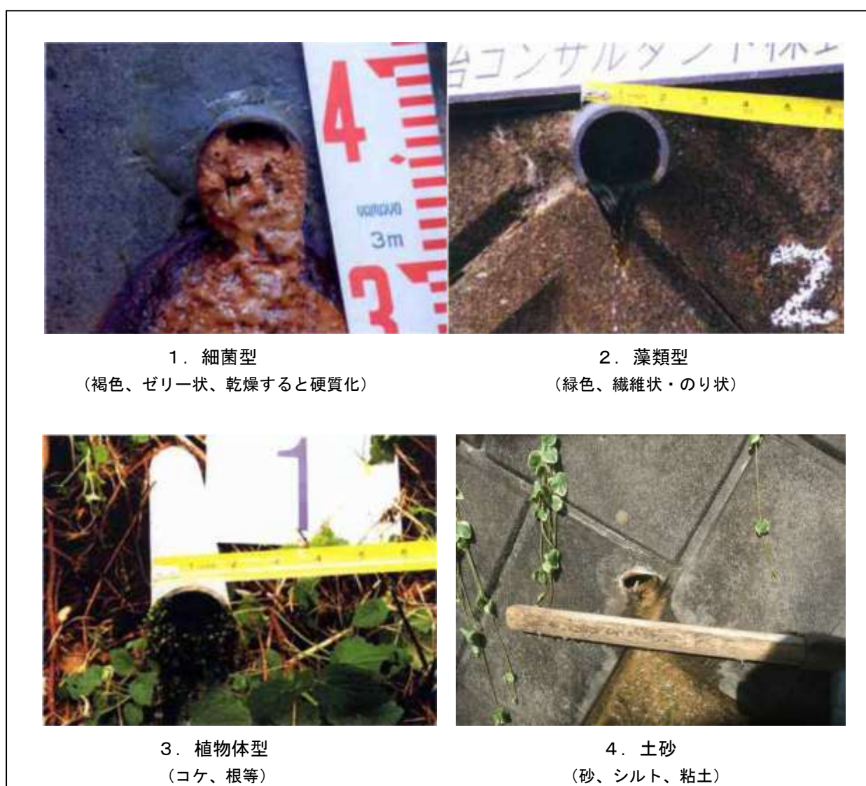
図 3.4.2 水抜きボーリング孔の目詰まり物質の種別
