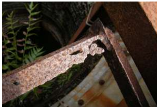
点検梯子の腐食 (断面欠損)
