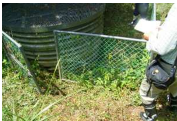
井筒周囲の陥没、井筒傾倒、安全柵破損 (吸い出し現象による井筒周囲の陥没に伴う変形)
