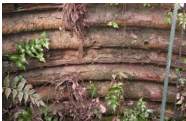
ライナープレート、補強リングの腐食 (剥離、減厚顕著)
