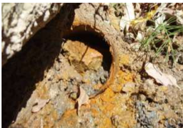
排水ボーリング出口の埋没 (破断するとともに土砂で閉塞、排水なし)
