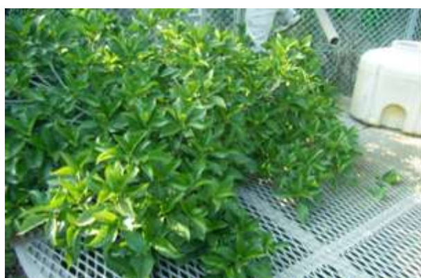
集水井内部から伸びた樹木 (幹径約 3cm)
