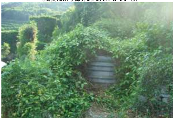
写真 2.3.3 集水井周辺植生状況 (集水井を覆いつくす植生)
