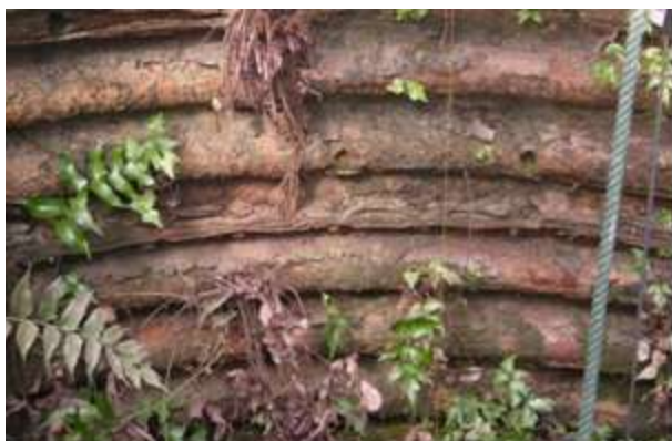
写真 2.2.1 ライナープレート・補強リングの腐食 （錆による剥離・減厚顕著）
