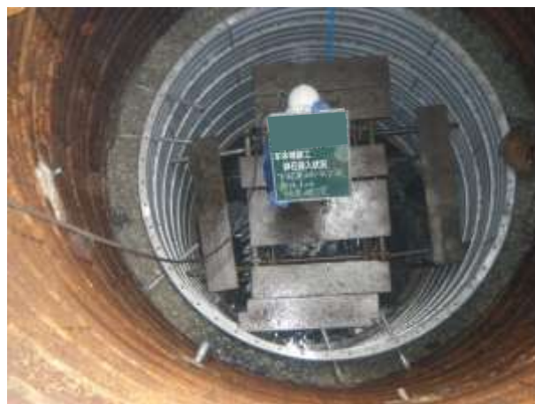
パイプ類接続状況
