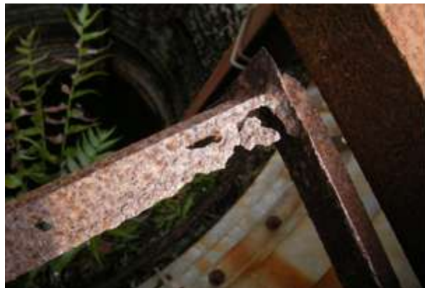
写真 2.3.2 タラップ腐食状況 (腐食により断面欠損顕著)
