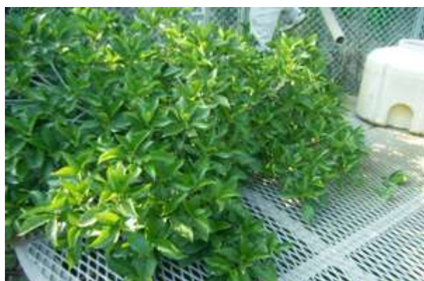
写真 2.2.4 集水井内部から伸びた植生 （樹木：幹径約3cm）
