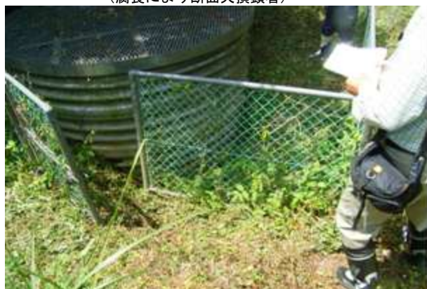
写真 2.3.4 陥没による本体傾倒・柵破損 (吸出し現象による本体周辺の陥没に伴う変形)
