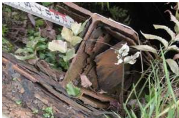
写真 2.2.2 パーチカルスティフナーの腐食 （錆による剥離・減厚顕著）
