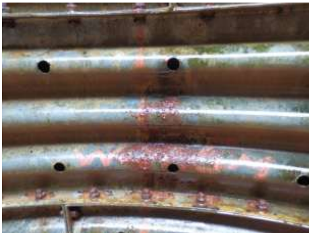
壁面洗浄後の発錆状況
