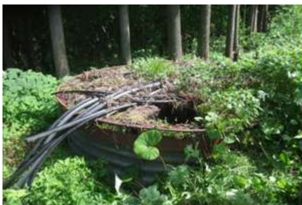
写真 2.3.1 天蓋腐食状況 (腐食により部分的に欠落している)
