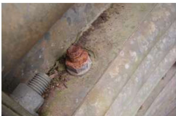
写真 2.2.3 連結金具の腐食 （ライナープレートは錆ずにボルトのみ錆発生）
