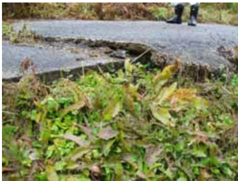
図3-14 道路に発生した段差
