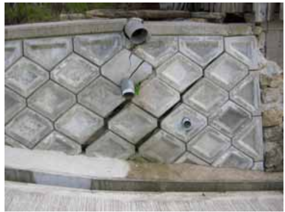
図 3-10 擁壁に発生した亀裂
