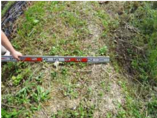
畦塗りを厚くして亀裂を埋め、畦からの漏水を防止する（亀裂対応）
