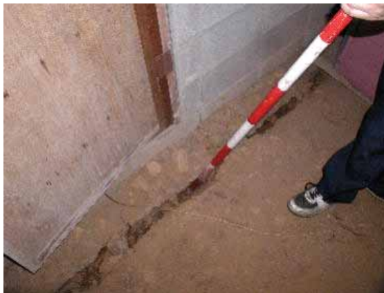
図 3-9 家屋に発生した亀裂
