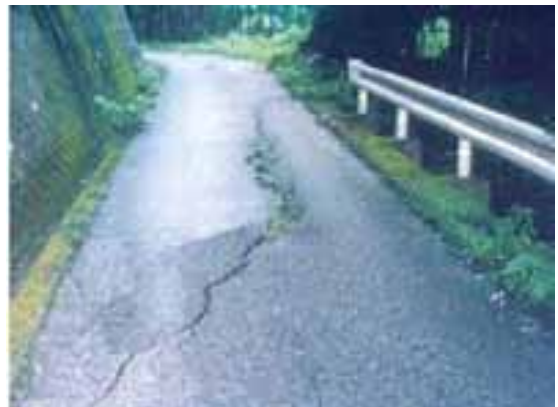
図 3-8 道路に発生した亀裂
