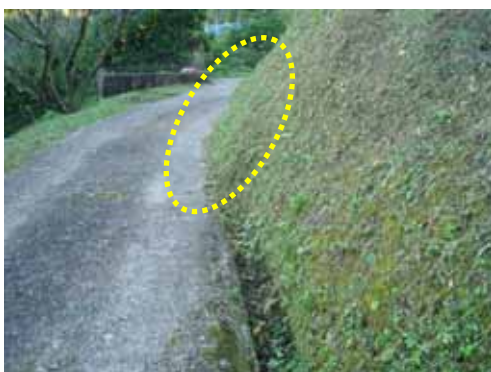
図3-16 道路脇のはらみ出し
