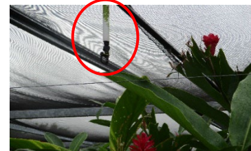
天井からのミスト散水装置
