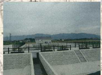
右岸高瀬揚水機場
