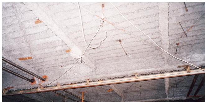
(天井への吹き付け石綿の劣化状況)
