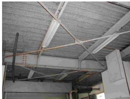
(建物天井への飛散性吹き付け石綿の状況)
