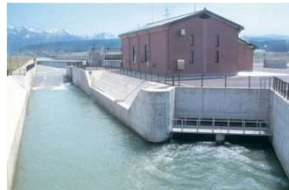
農業水利施設を活用した小水力発電
