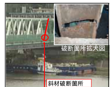
図6 本荘大橋斜材破断
