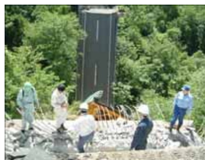
図2 岩手・宮城内陸地震(H20.6)における被害状況(祭時大橋)
