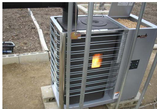
稼働中のペレットストーブ
