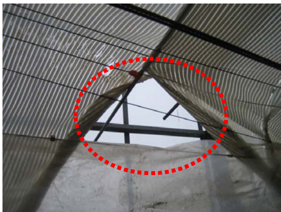
写真-1 1 屋根カーテン閉時の妻面の隙間
