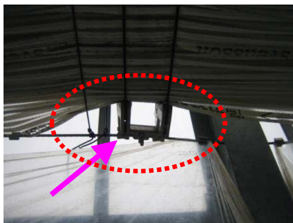
写真-1 6 肩部滑車部分の隙間
