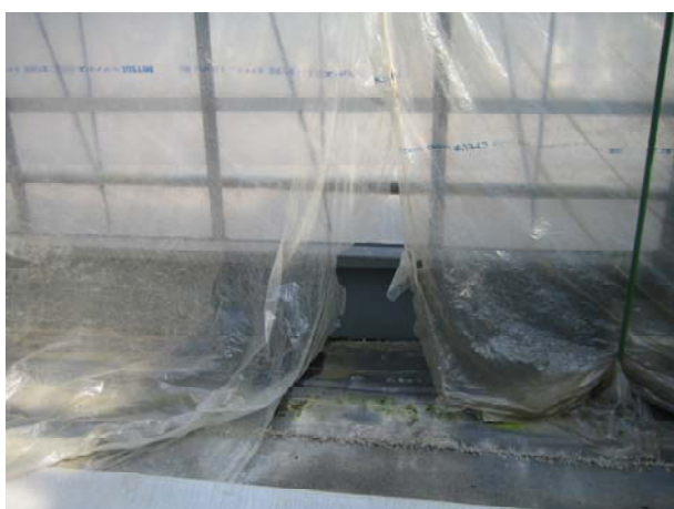
写真－9 内張カーテンの破れ1
