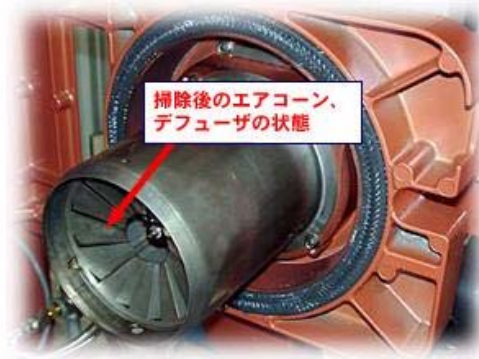
【掃除後のエアコーン、デフューザの状態】
