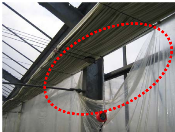
写真-1 4 肩部垂れ下り隙間
