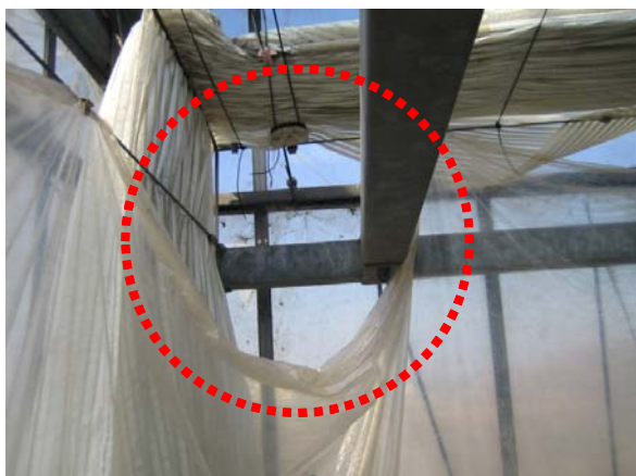
写真-1 3 温室コーナー部分の隙間
