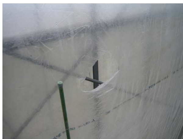
写真－10 内張カーテンの破れ2
