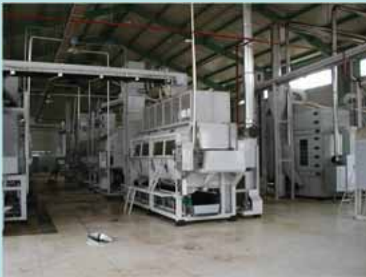
製茶工場の状況(多くの熱損失あり)
