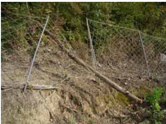
倒木により一部が押し下げられたネット柵
