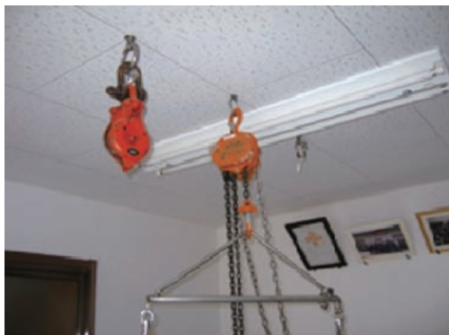
図 2-2 懸ちょう設備
