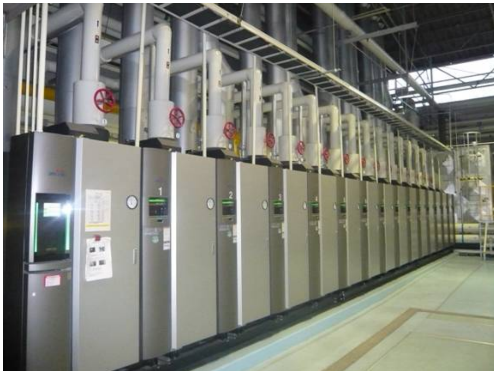
図表 ボイラー(天然ガス)
