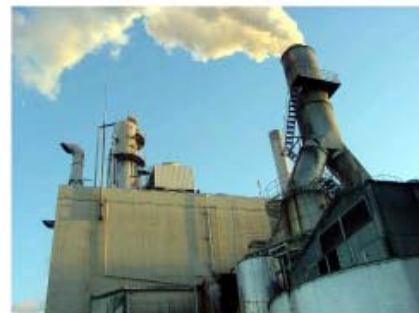
排煙脱硫装置
