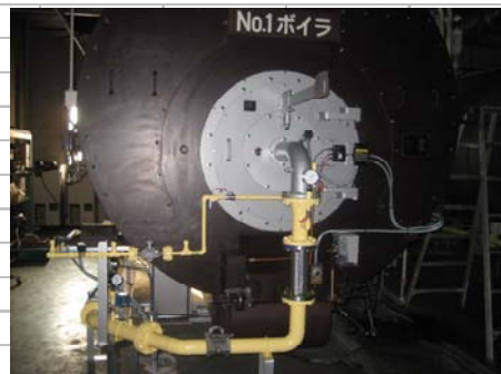
ボイラ 7t×2基
