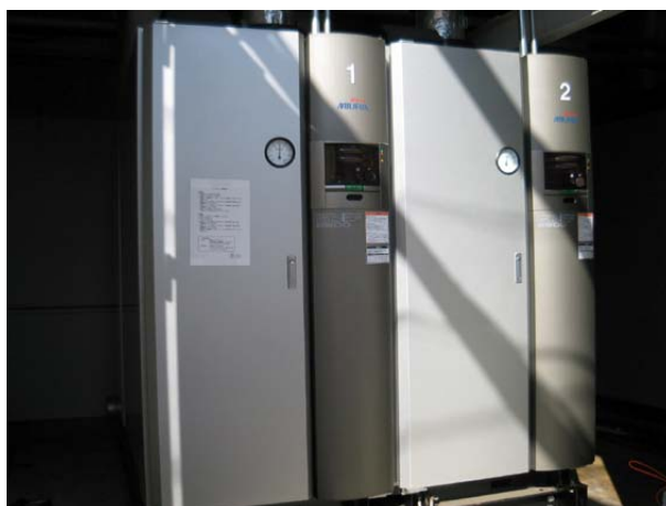
図表 ボイラー(都市ガス)
