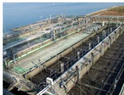
総合廃水処理施設
