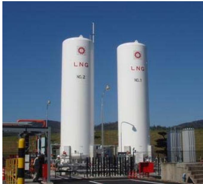
図表 LNG サテライト基地
