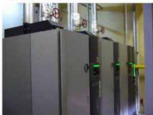
更新後ボイラー(ボイラー、附属設備)
