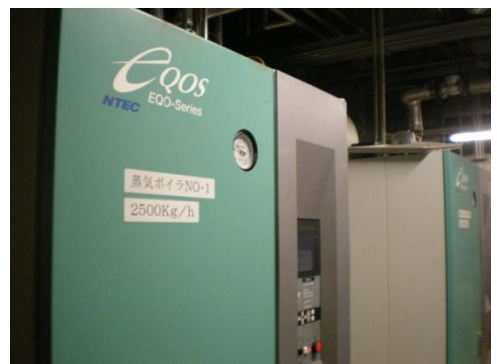
貫流ガス焚きボイラー
