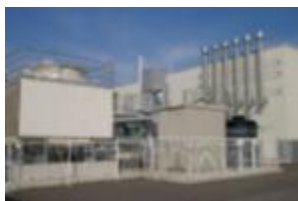
コージェネレーション設備
