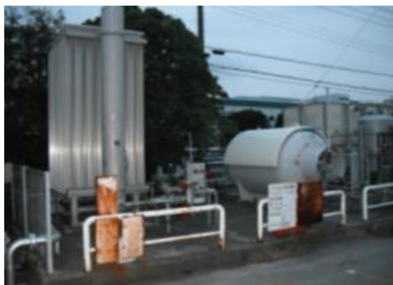
【改善前】LPG供給設備
