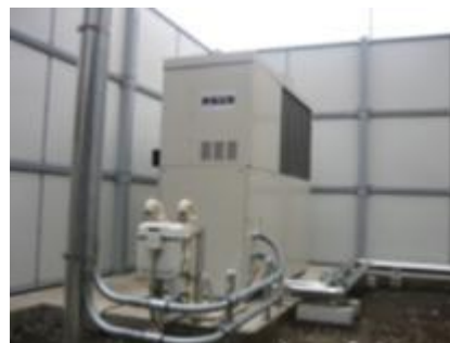
コージェネレーション25kW×一基
