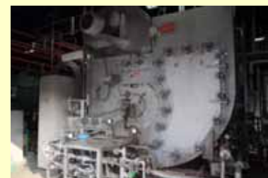
【副生油混焼ボイラ】
