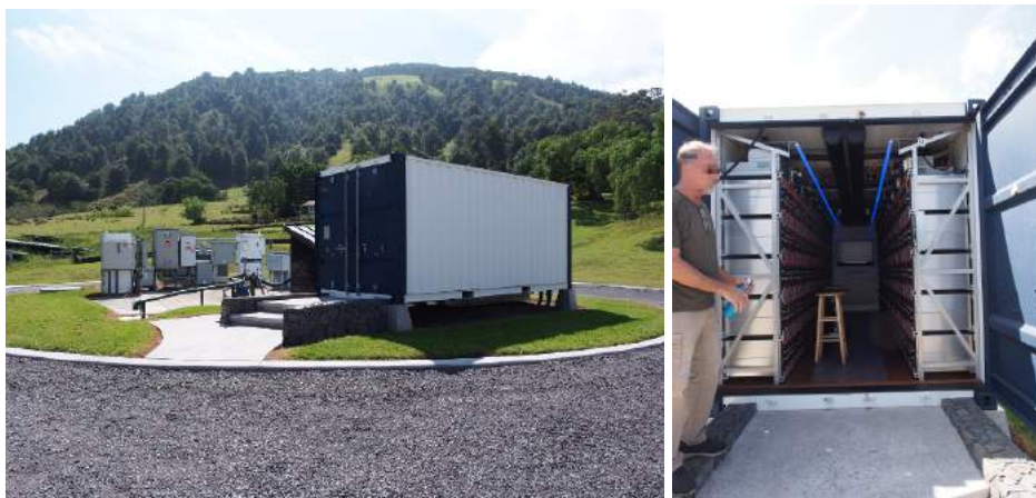
図2.3.2-1 ソニー製バッテリーシステム
