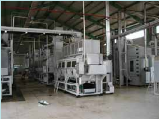
製茶工場の状況(多くの熱損失あり)
