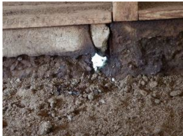
鶏舎基部の隙間
