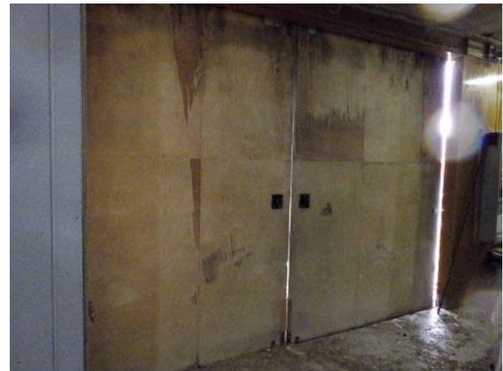
鶏舎外側出荷用出入口扉の隙間
