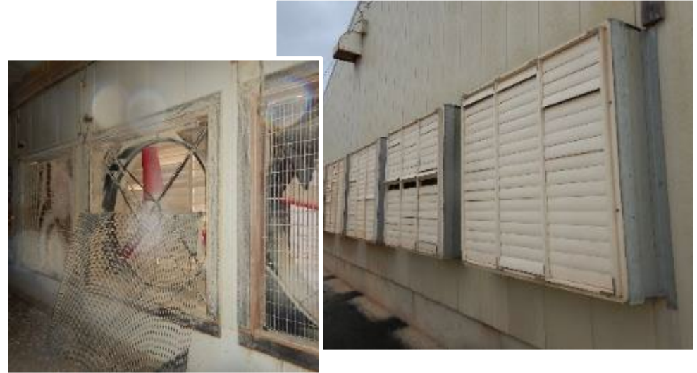
排気ファンの金網脱落・シャッター破損
