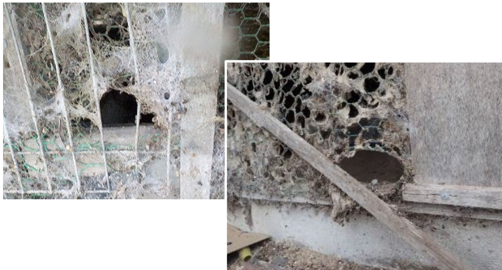
鶏舎開口部の金網の破損・湾曲
