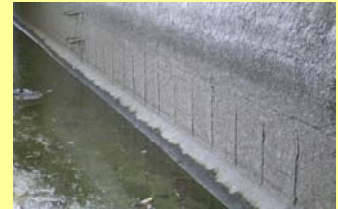
水路側壁の摩耗状況
