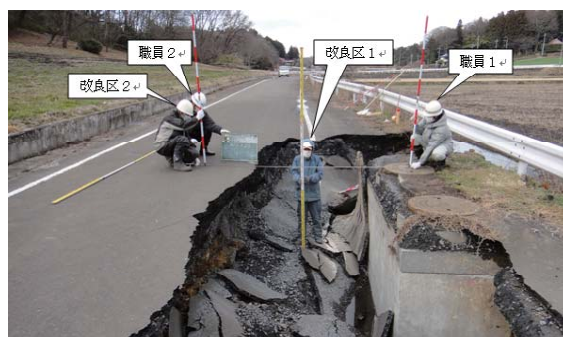
被災箇所の調査 いちかいまち (栃木県芳賀郡市貝町)
