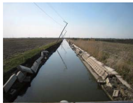
液状化により被害を受けた水路 (千葉県香取市)
