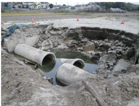
ヒューム管が離脱したパイプライン (茨城県古河市)
