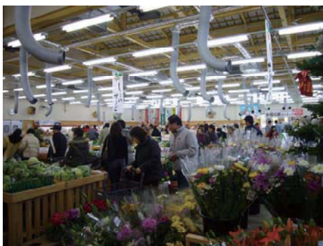
「しょいか〜ご」パイプ空調
