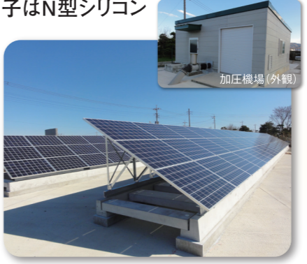
羽根倉幹線付帯機場 太陽光発電設備
