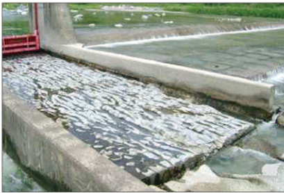
頭首工土砂吐の摩耗
