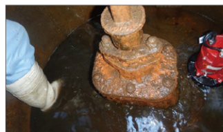
制水弁腐食状況
