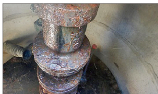
空気弁腐食状況
