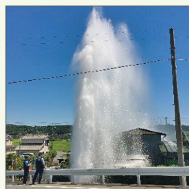
腐食した空気井からの漏水
