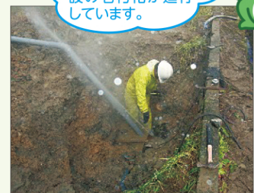
幹線水路(鋼管)の腐食による漏水
