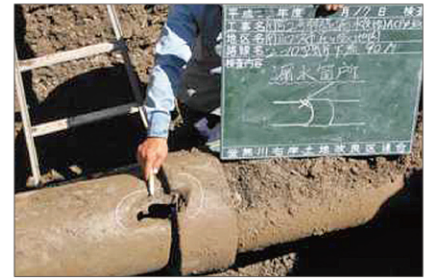
管水路継手部破損
