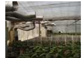
(ヒートポンプ)
