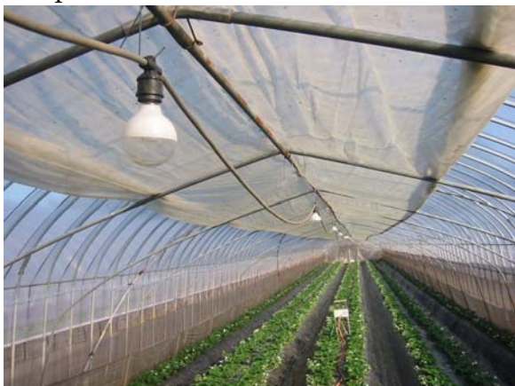
<写真 part 3>電照設備
