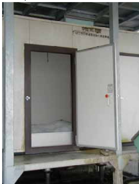
<写真part 3> 製氷機設置状況
