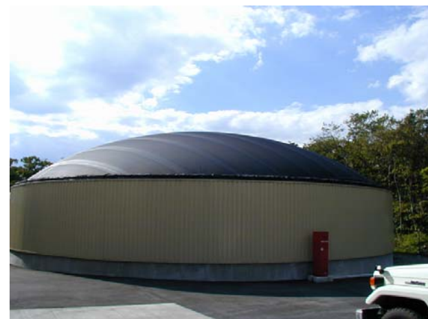
⑨整備されたエネルギー等副産物(バイオ(メタン)ガス貯留)処理施設【富士ヶ嶺地区】
