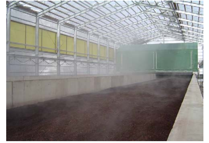
⑥整備された家畜排せつ物処理施設【新治地区】
