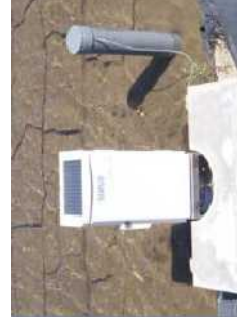
自動給水栓の導入
