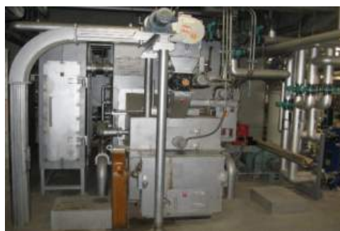
市内施設のペレット給湯ボイラー
