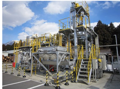
写真4 木質バイオマスガス化発電試験施設 (滋賀北部森林組合)
